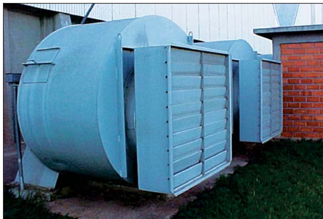
Figura 7: Ventilador ou exaustor
